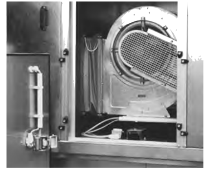
Kabelführung / elektrische Kupplungen
